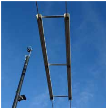
„Korytka“ nad trolejí zabraňují dotyku živých částí (tj. částí trvale pod proudem) s jinými vodiči. Zde v zastávce Divoká Šárka. Foto: Jiří Šimůnek
