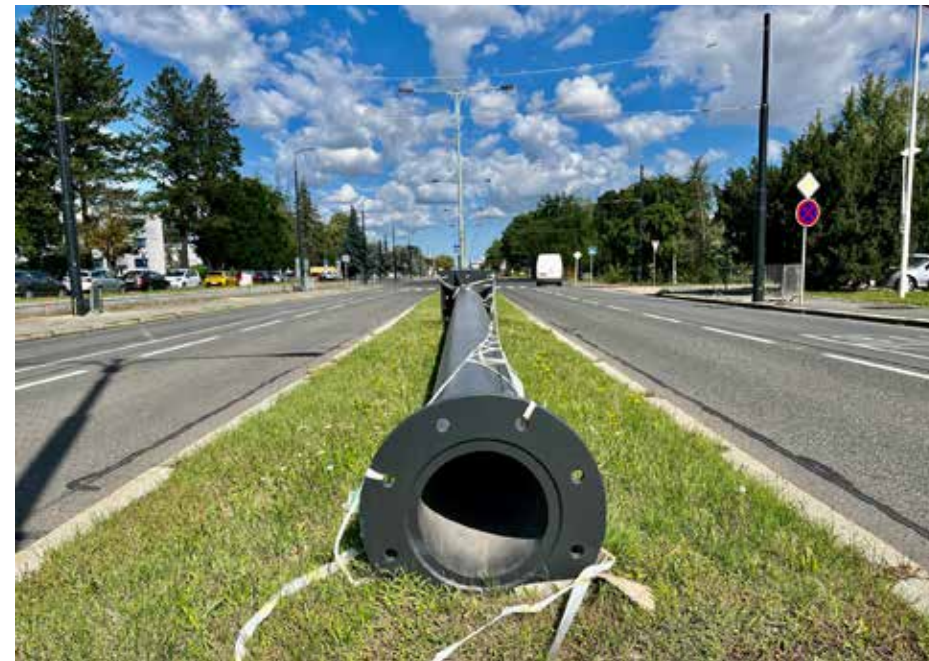
Záběr ze srpna 2023 ukazuje stav výstavby trolejbusové infrastruktury v ulici K Letišti, kde je dnes zavěšena čtyřstopá trať, přičemž dvě stopy slouží jako posilovací vedení. Sloup, který snímku dominuje, je určen jako podpěra pod stožár trolejového vedení situovaný u mostu přes Pražský okruh. Takto nadstavené sloupy jsou pak navíc ještě dále ukotveny k dalším stožárům. Foto: DPP
