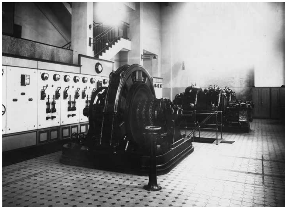
Pohled na vybavení prvorepublikové měřírny Teslova. Zařízení bylo vážně poškozeno při náletu v roce 1945. Sbíрка: Archiv DPP
