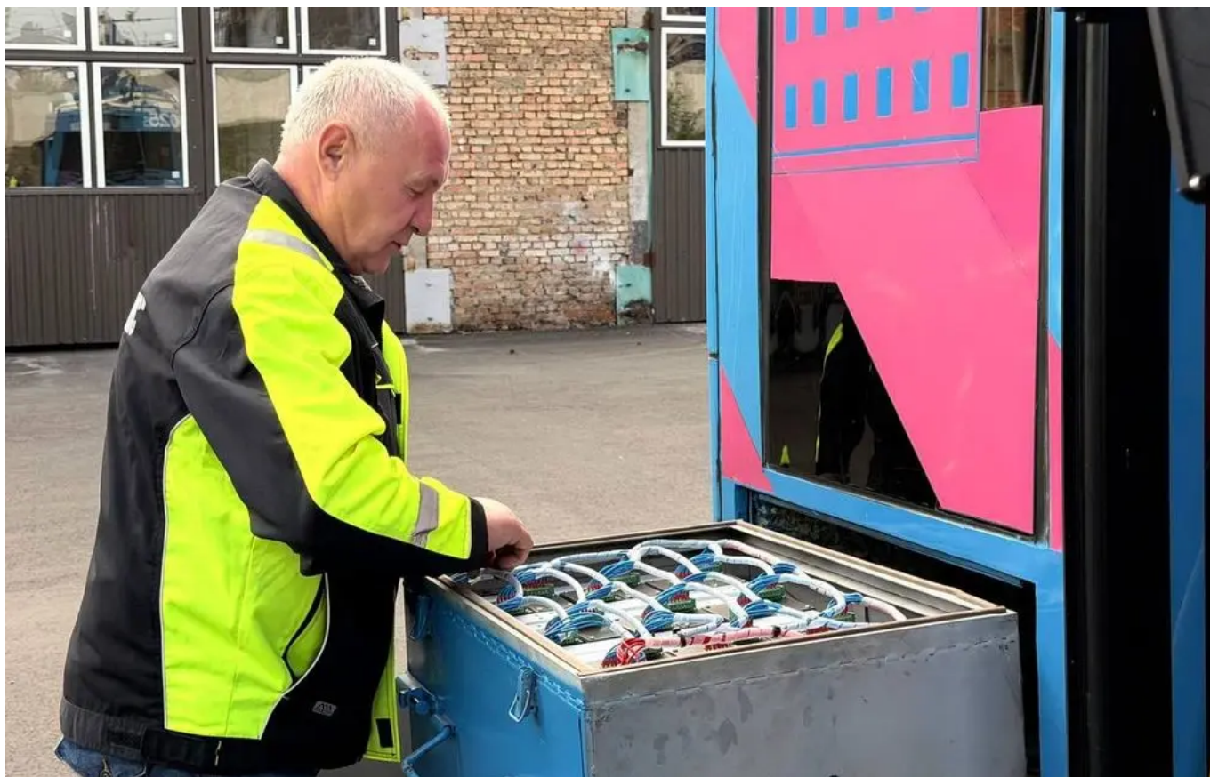
Baterie umístěné na zadním čele jsou přístupné z boku. (foto: Mykolaivelektrotrans)
