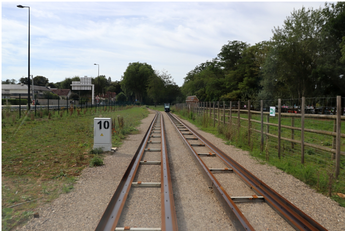
Kolejnice jsou položeny „na boso“. Půda pod nimi byla pouze tlakem ztuhněna. (foto: Ing. Vojtěch Kudláč)
